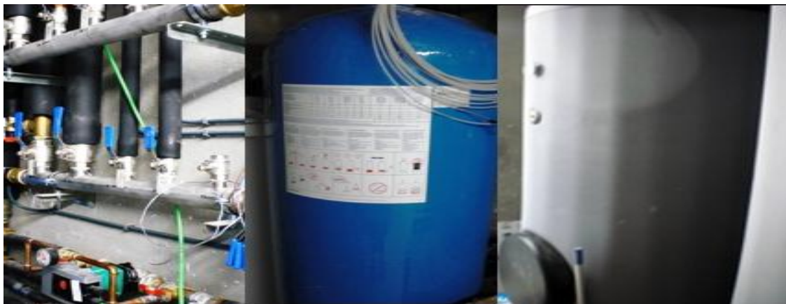
Foto 1: Acumulador aigua sanitària i dipòsit del descalcificador del centre.
