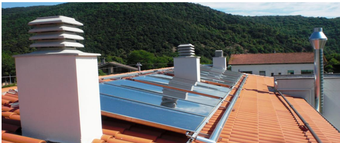
Foto 2: Plaques solars instal·lades al nostre recurs.
